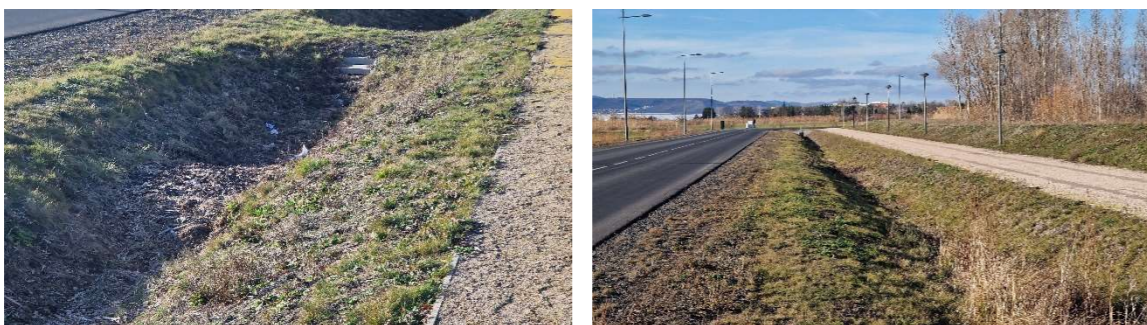
Exemples de redans en noue de collecte des eaux pluviales (Zone de Sarliève sud – Cournon)
