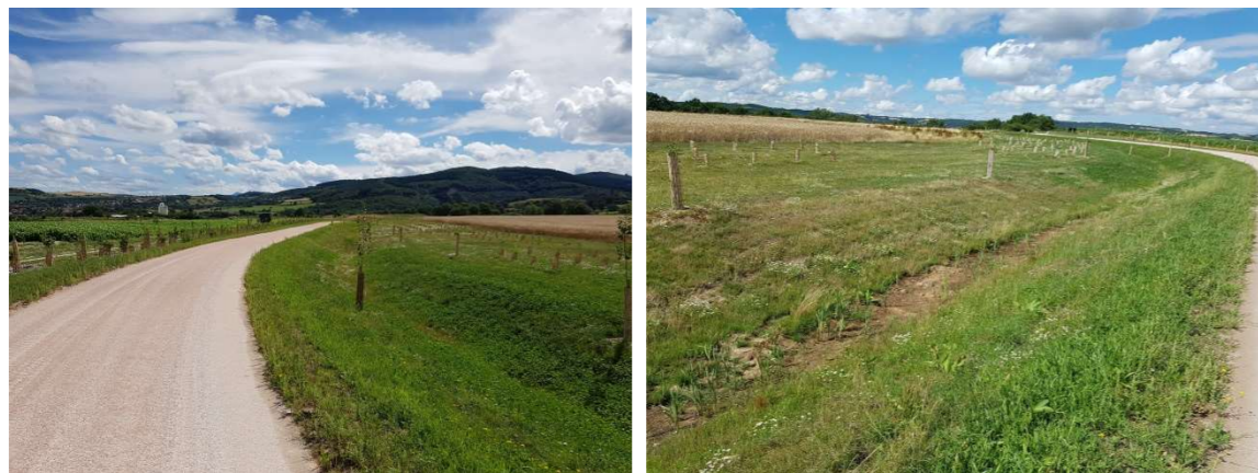
Exemples de noue de collecte des eaux pluviales (parc de l'Aize – Combronde)
